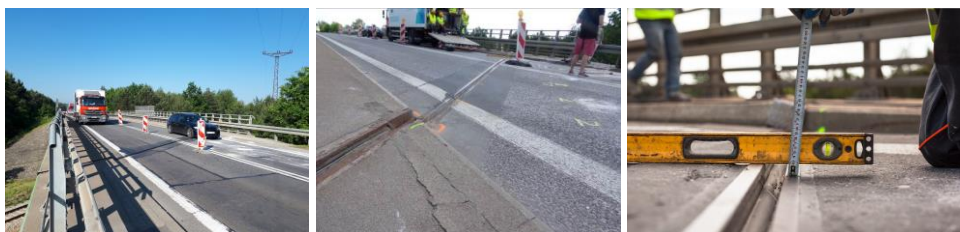
Rysunek 3. Progi na dylatacji modułowej spowodowane osiadaniami nasypu. (Geobear sp. z o.o.)
