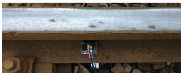
Rys. 2. Wada 221 – uszkodzenie powierzchni tocznej [fot. autorów]
