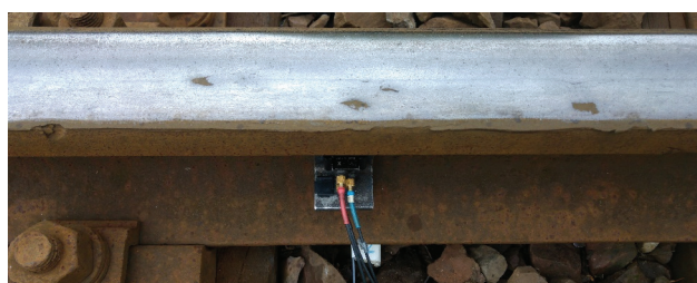
Rys. 2. Wada 221 – uszkodzenie powierzchni tocznej [fot. autorów]
