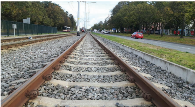
3. Stan toru oraz przeszkody terenowe na odcinku d
