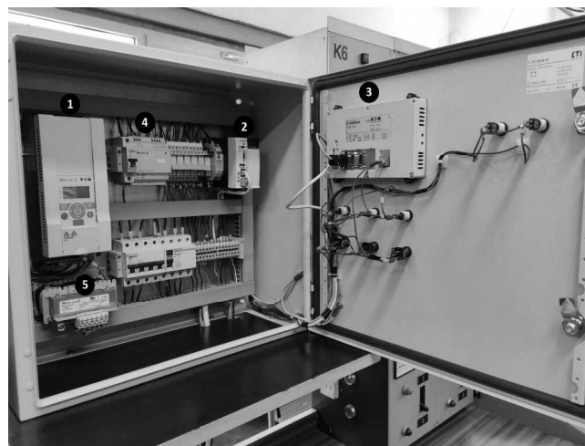
Rys. 4. Widok szafy sterowniczej (1 – przemiennik częstotliwości, 2 – sterownik programowalny, 3 – panel operatorski, 4 – zasilacz, 5 – filtr sieciowy)
