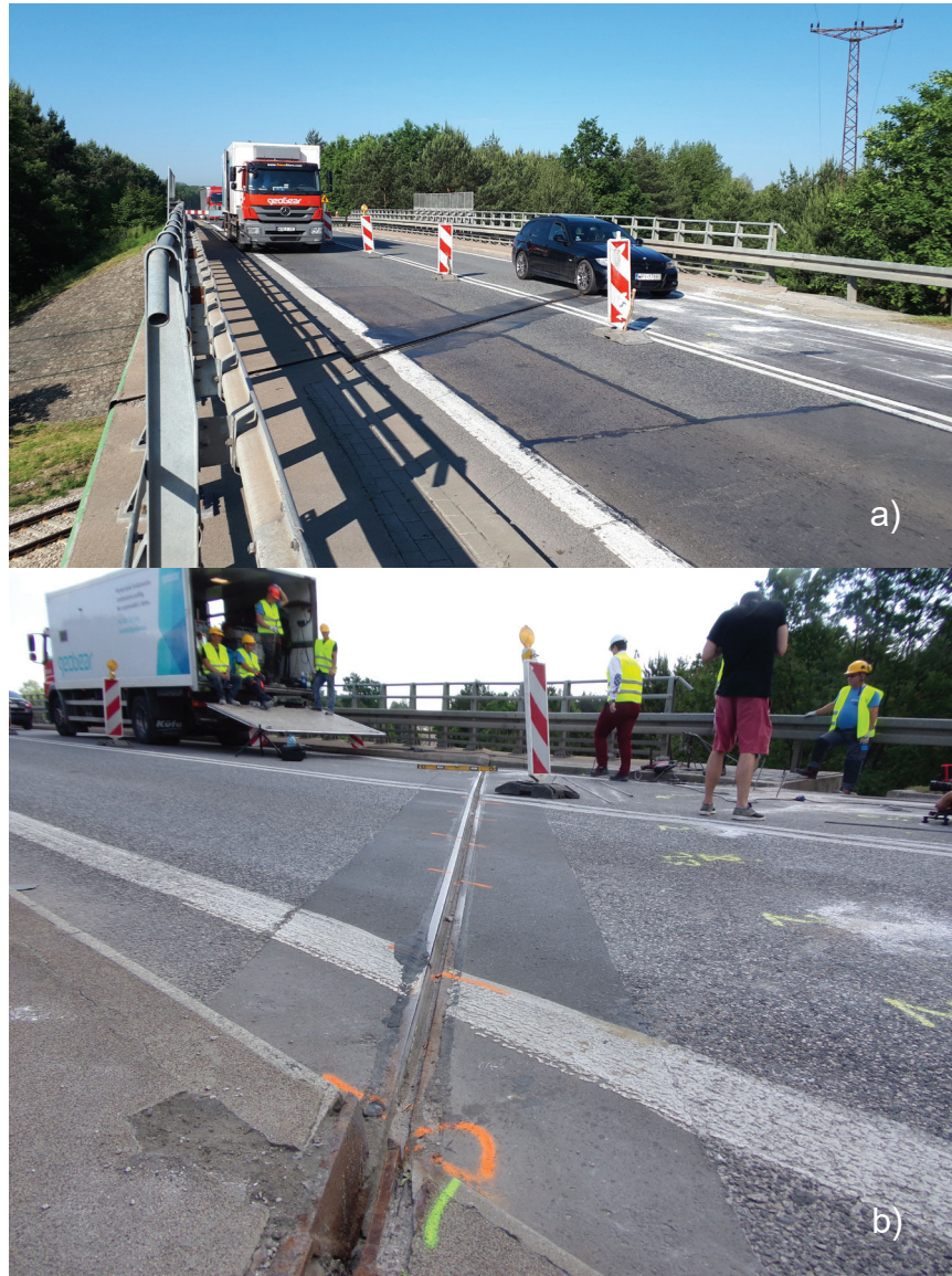
Fot. 2. Progi na dylatacji modułowej spowodowane osiadaniami nasypu (Geobear Sp. z o.o.)
