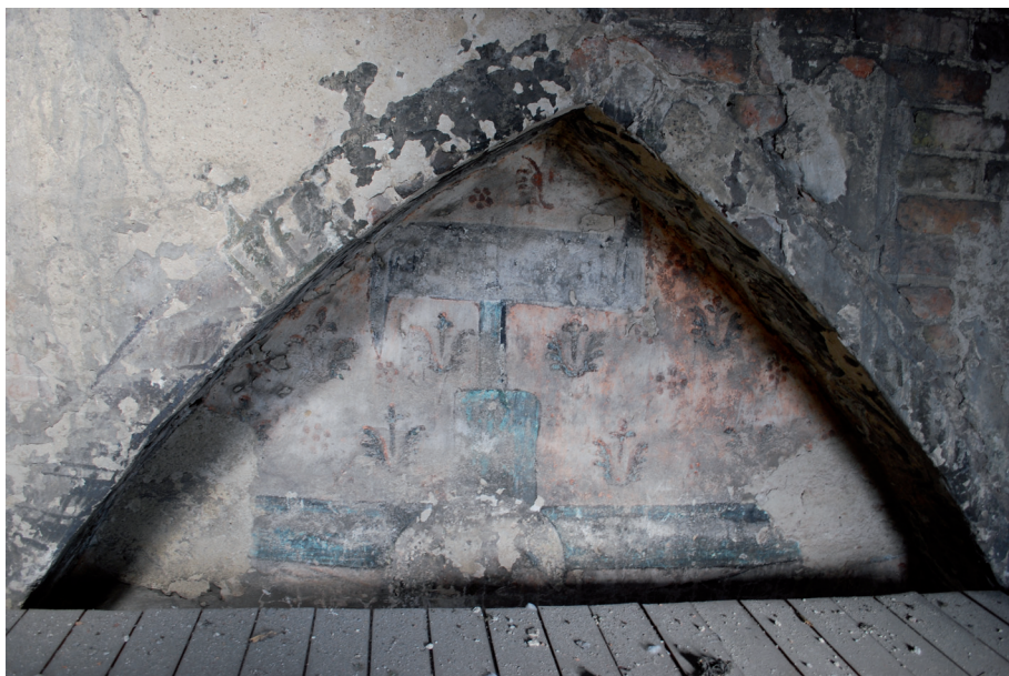
Il. 2. Górny fragment Ukrzyżowania w centralnej blendzie na fasadzie kościoła, stan z 2013 r. Fot. P. Samól
