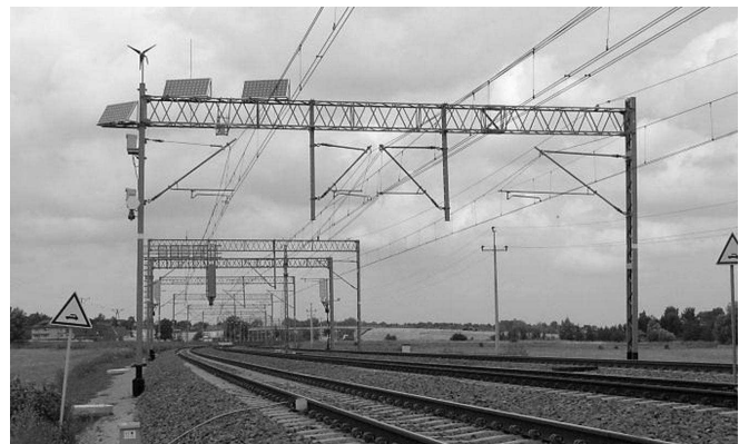
Rys. 14. Stanowisko MOP na linii kolejowej (źr. archiwum KIET)
