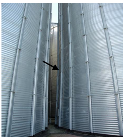
Rys. 2.4. Wyboczenie ściany silosu o wysokości 23.3 m i średnicy 12.5 m [Iwicki i inni 2011]
