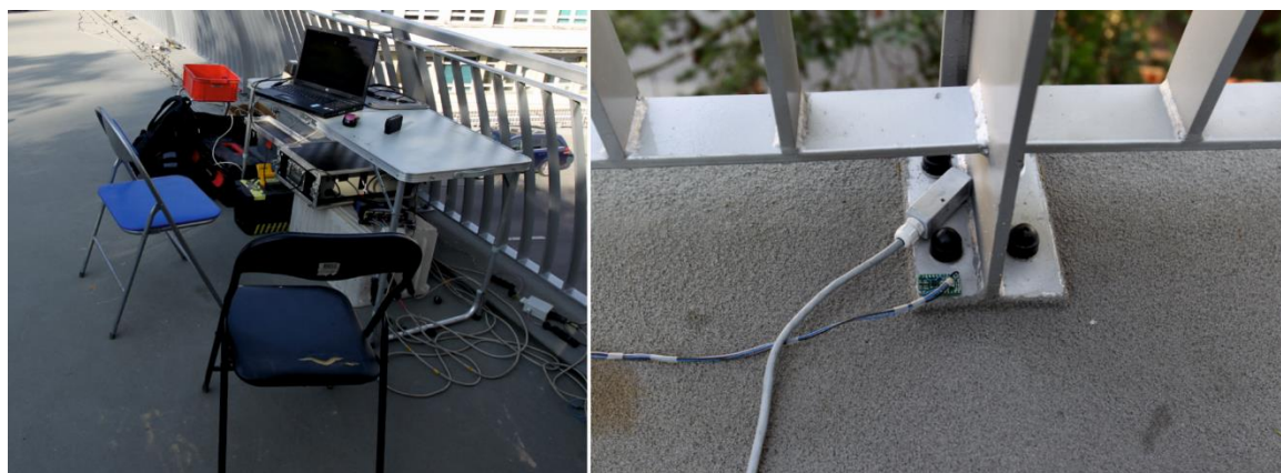
Rysunek 6.44 Stanowisko pomiarowe oraz montaż czujników na kładce na ul Chwarznieńskiej w Gdyni
