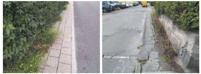
Fot. 10. Roślinność zabierająca przestrzeń chodnika oraz zły stan techniczny chodnika na ulicy Lęborskiej (fotografie – zasoby własne autorek)
