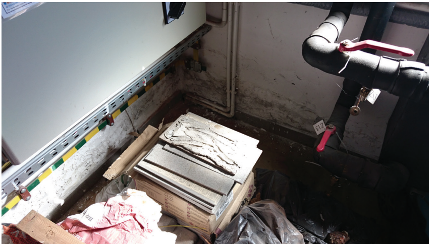
Fot. 2. Uszkodzenia wilgotnościowe na ścianie podłużnej kotłowni w budynku Sali BHP
