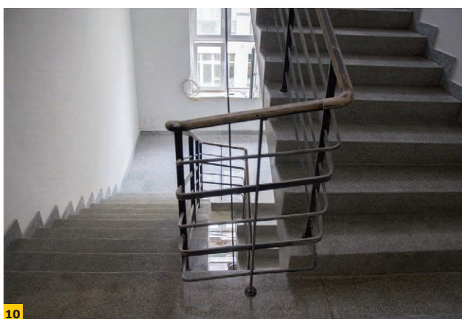
FOT. 9–10. Ubytki kruszywa w warstwy wierzchniej posadzki typu lastrico przed (9) i po naprawie (10); fot.: [15]
