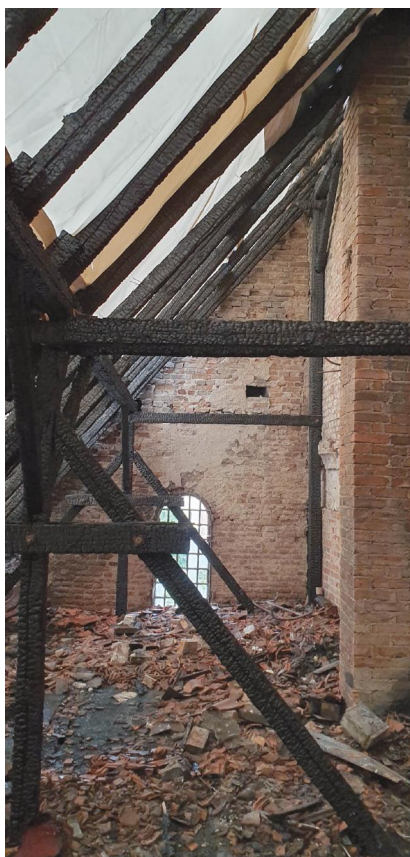
Rys. 4. Widok pogorzeliiska oraz uszkodzonej pożarowo drewnianej konstrukcji zadachowania nad pomieszczeniem nad zakrystią w nawie bocznej kościoła pw. Świętych Apostołów Piotra i Pawła w Gdańsku
