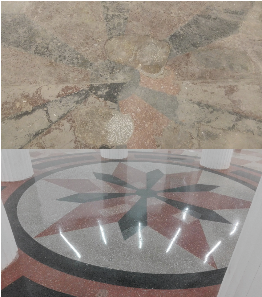
Fot. 4. Posadzka typu lastrico przed i po naprawie [M3]
