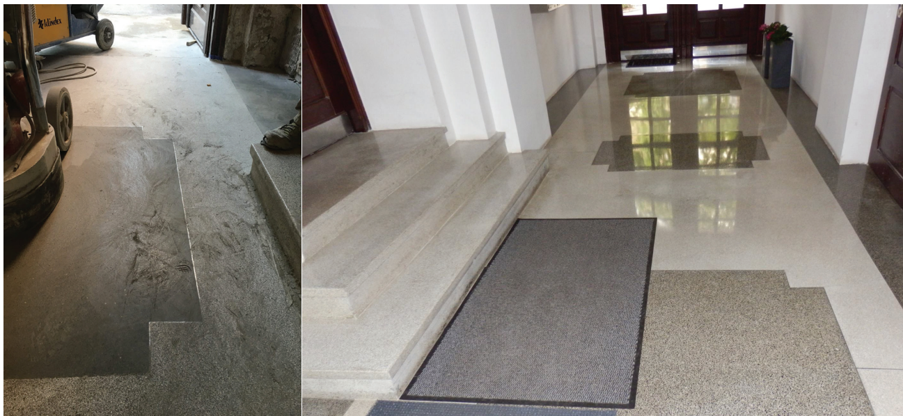
Fot. 5. Szlamowanie nawierzchni i wizualny efekt końcowy odtworzonej w obiekcie zabytkowym posadzki typu lastrico [M1]
