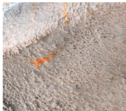
Fot. 2. Zbliżenie na torkret z inhibitorem korozji po 6 miesiącach od naprawy [źródło: Marcin Majewski]
