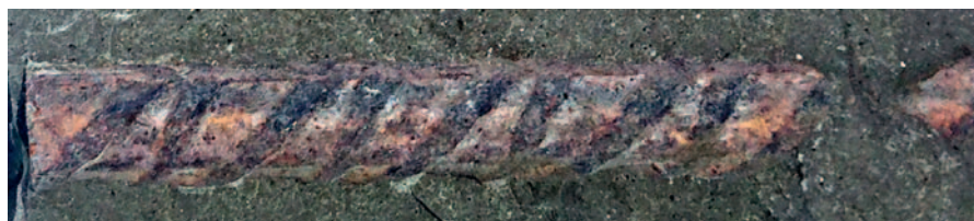
Fot. 6. Widok na pręt bez ochrony katodowej, widoczna korozja całej powierzchni pręta [źródło: Marcin Majewski]
