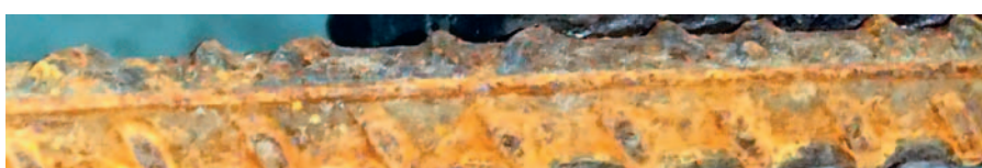
Fot. 7. Szczegół pręta bez ochrony katodowej, widoczna korozja całej powierzchni pręta [źródło: Marcin Majewski]
