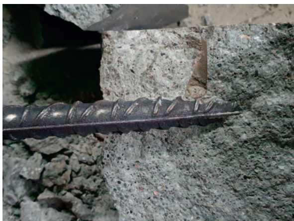
Fot. 4. Widok na chroniony pręt zbrojeniowy w miejscu podłączenia protektora [źródło: Marcin Majewski]
