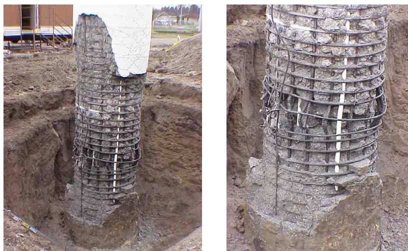
Rys. 101 Powstanie przegubu plastycznego na wysokości h=60 [cm] od fundamentu w oparciu o założenie koncepcji Ductility Demand-Capacity ([76] Mahan 2009)
