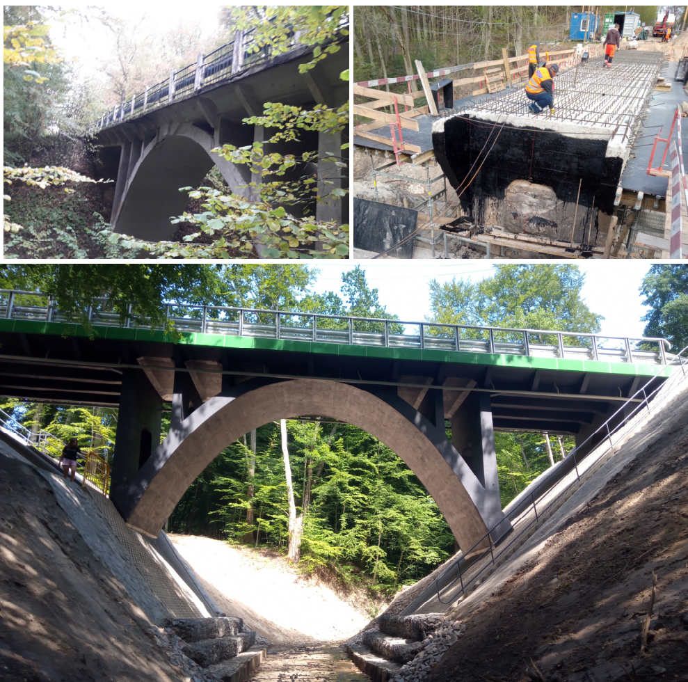
Rysunek 1. Most w Jagodniku w ciągu drogi powiatowej nr 1131N: a) przed przebudową, b) w trakcie przebudowy, c) po przebudowie i oddaniu do użytkowania
