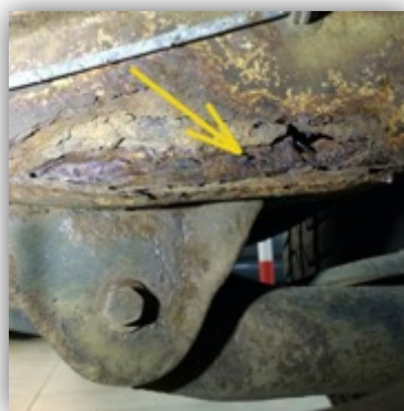
Rys. 2.8. Nadmierna korozja elementów konstrukcyjnych
