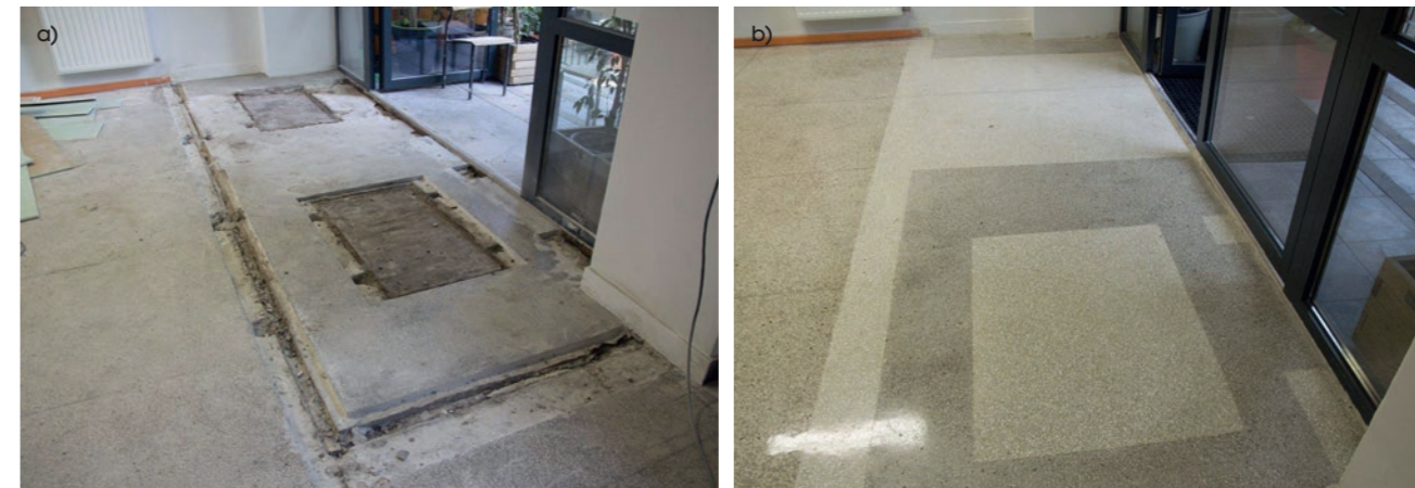
Fot. 2. Naprawa i renowacja posadzki typu lastrico w budynku szkoły – posadzka: a) przed naprawą, b) po naprawie (M1)
