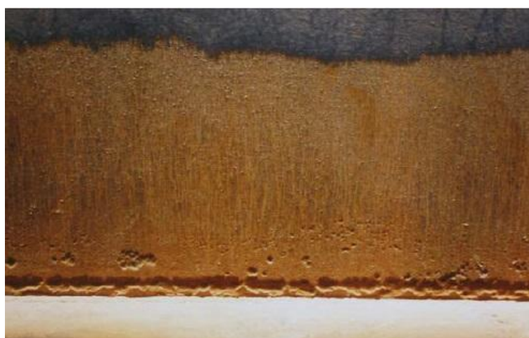
Rys. 1.15. Uszkodzenia korozyjne płaszczu zbiornika ( V = 12\ 000\ m^3 ) w strefie połączenia płaszczu z dnem [12]
