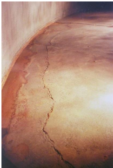
Rys. 1.12. Wżer korozyjny w dnie zbiornika w miejscu zawalcowania wtrąceń niemetalicznych (siarczków)
