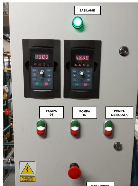
Rys. 6. Widok ogólny rozdzielni zasilająco-sterującej stanowiskowej do badania pomp wirowych
