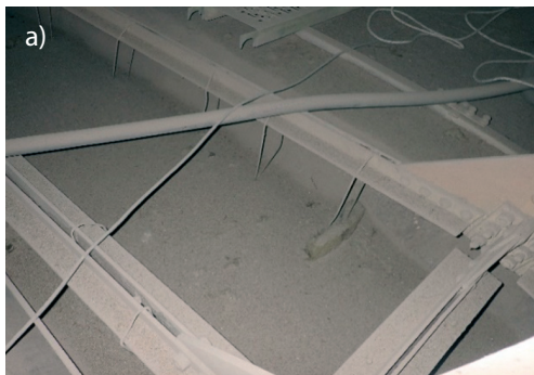
Rys. 6. Gurt pomiędzy łupinami SK-2 i SK-3-widok: a) ogólny, b) w zbliżeniu
