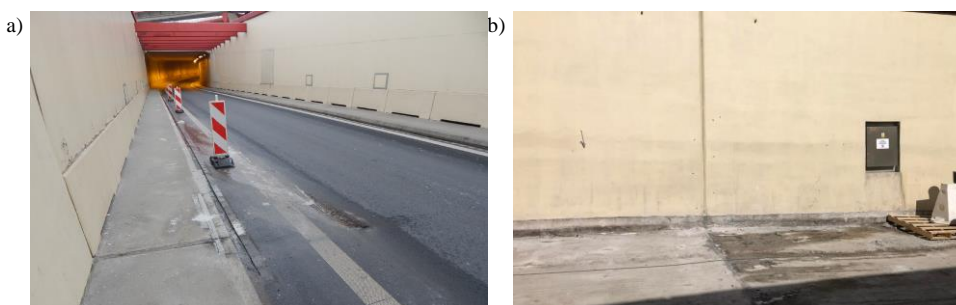
Rysunek 12. a) Przekięki wody na nawierzchnię na połączeniu konstrukcji w ścianach szczelinowych z konstrukcją wanny b) Przekięki wody na nawierzchnię na połączeniu konstrukcji dwóch konstrukcji wanny.
