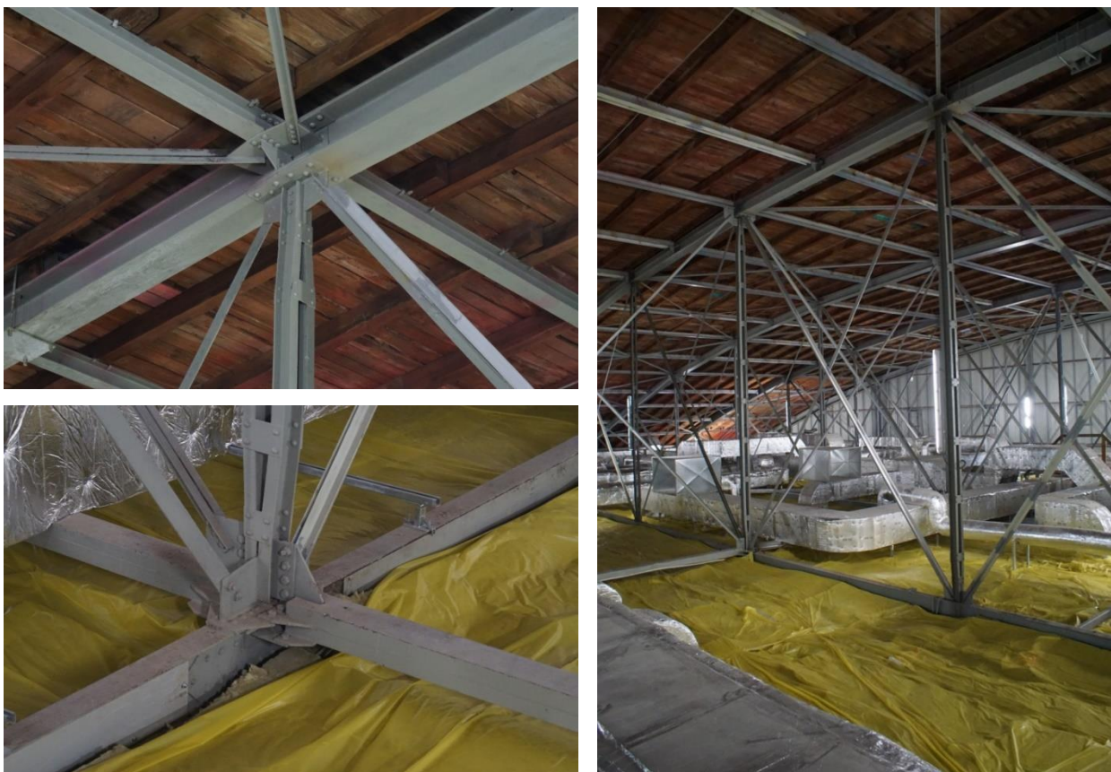
Il. 3.07. Nitowana konstrukcja stalowa w dawnym hangarze lotowskim. Zdjęcia z remontu prowadzonego w 2016 r. Fot. J. Szczepański.
