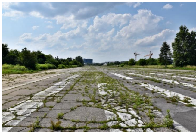
Il. 4.34. Dawny pas startowy, widok w kierunku północno-zachodnim, 2021 r. Fot. A. F. Szuta.
