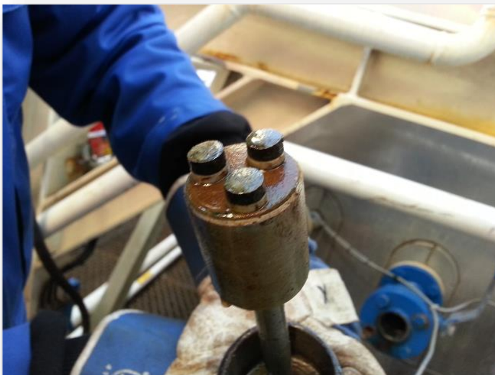
Rysunek 22. Czujnik monitorowania korozji.
