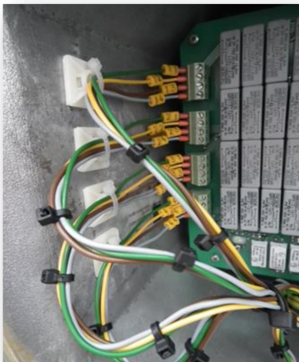
Rysunek 50. Przewody od czujników korozji podłączone do płyty pomiarowej.
