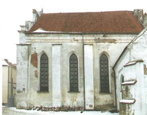
9. Barczewo. Kościół Świętego Andrzeja. Elewacja południowa korpusu, w całości pokryta cementowym tynkiem, stan przed rozpoczęciem prac konserwatorskich w 2018 roku. Fot. Damian Kwiecień – Gorek Restaura.
