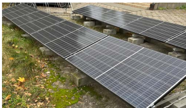
Rys. 1. Badawcza instalacja PV na terenie Politechniki Gdańskiej
