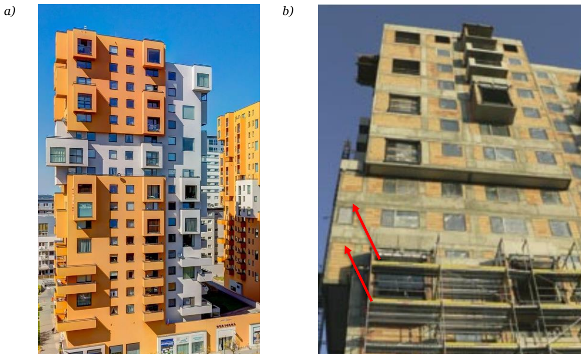
Rys. 2.2 Budynki mieszkalne „Horyzont” w Gdańsku [8]: a) widok ogólny na elewację, b) widok wykuszy kilkukondygnacyjnych wspartych na żelbetowych ramach z tarczowymi wspornikami (oznaczenie czerwonymi strzałkami).
