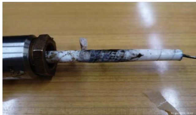
Rys. 12 Uszkodzony rdzeń izolatora
