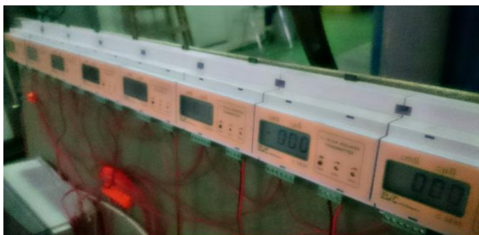
Rysunek 55 Skalibrowane przetworniki przewodności elektrycznej
