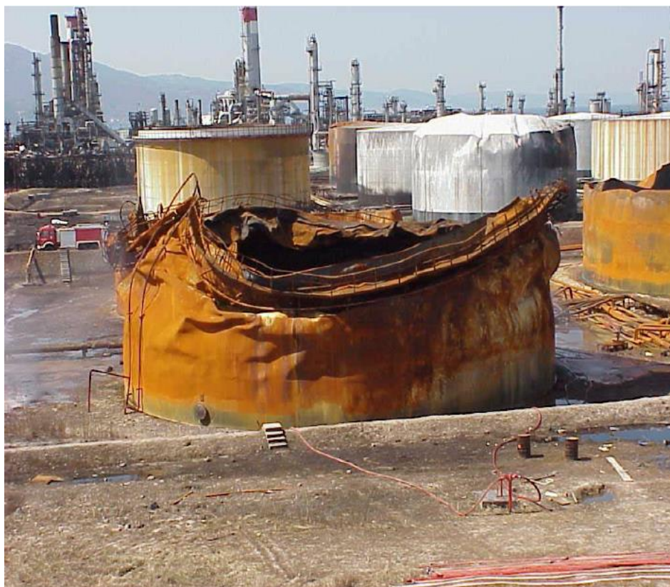
Rys. 2.6. Uszkodzenia zbiornika na benzynę w rafinerii Tüpraş podczas trzęsienia ziemi z dnia 17.09.1999, Kocaeli, Turcja ( http://www.researchgate.net )
