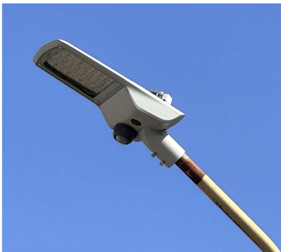
Fot. 12. Lampa inteligentna z Modułem Głównym i czujnikiem PIR
