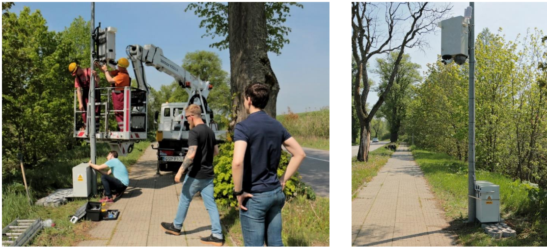
Rys. 58. Proces instalowania urządzenia pomiarowego. U dołu szafka zasilająca. Lokalizacja Leźno, Aleja Lipowa
