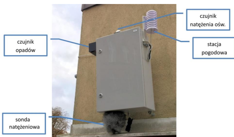
Rys. 55. Szafa pomiarowa z czujnikami zewnętrznymi, widoczny sposób doprowadzenia zasilania.
