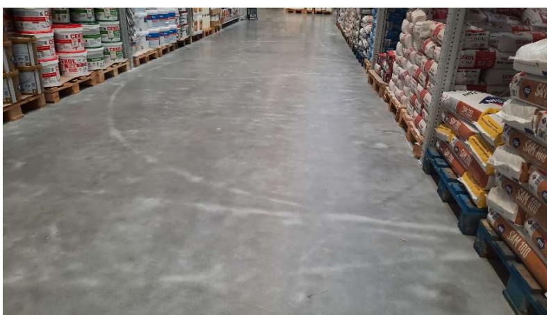
Rys. 8.19. Uszkodzenia chemiczne posadzki podczas jej eksploatacji – studium przypadku (fot. S. Świątek-Żołyńska)
