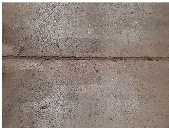
Rys. 8.7. Uszkodzenia posypki związane z zastosowaniem zbyt małej ilości utwardzacza powierzchniowego (fot. S. Świątek-Żołyńska)
