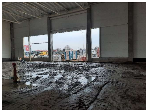
Rys. 8.15. Uszkodzenia spowodowane wadliwym wykonaniem podbudowy (fot. S. Świątek-Żołyńska)
