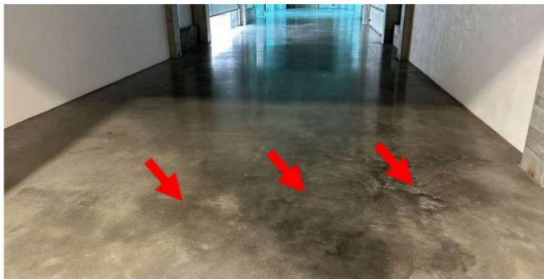
Rys. 10.11. Betonowa posadzka przemysłowa (Przykład 3) przed renowacją: strzałkami zaznaczono zimne złącza [M1]
