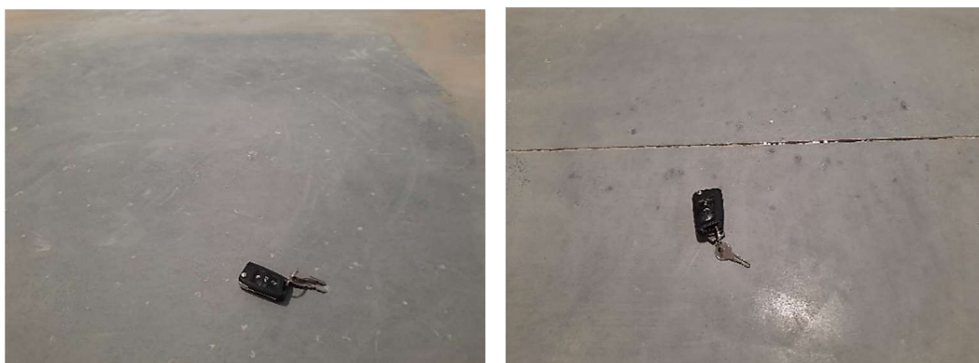
Rys. 8.12. Uszkodzenia spowodowane występowaniem zbyt dużego i zanieczyszczonego kruszywa w posypce utwardzającej (fot. S. Świątek-Żołyńska)
