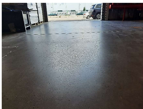
Rys. 8.8. Zniszczenie filmu cementowego w licu posadzki w strefie z nawożoną solą drogową (fot. S. Świątek-Żołyńska)
