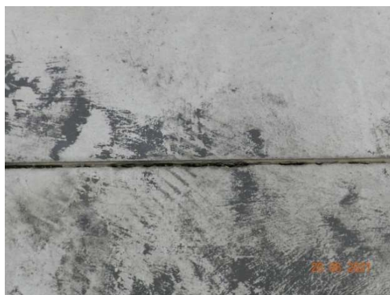
Rys. 8.3. Uszkodzenia będące konsekwencją zabrudzenia i przebarwienia posypki ( fol. S. Świątek-Żołyńska )
