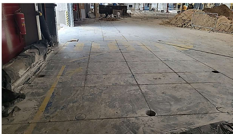
Rys. 12.1. Widok ogólny posadzki, podanej diagnostyce w ramach badań polowych, w głównych ciągach komunikacyjnych (fot. S. Świątek-Żołyńska)
