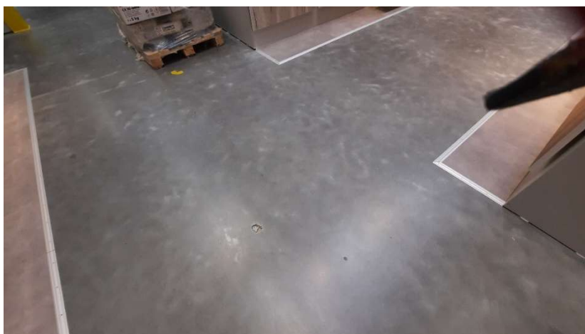
Rys. 8.20. Uszkodzenia chemiczne posadzki podczas jej eksploatacji – studium przypadku (fot. S. Świątek-Żotyńska)
