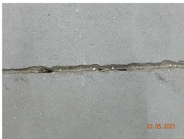
Rys. 8.2. Uszkodzenia szczeliny dylatacyjnej spowodowane brakiem fazowania krawędzi oraz ubytkiem wypełnienia (fot. S. Świątek-Żołyńska)
