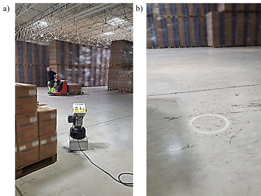
Rys. 11.2. Badania ścieralności metodą BCA: a) maszyna podczas badań, b) posadzka po zakończeniu pomiaru (fot. M. Niedostatkiewicz)
