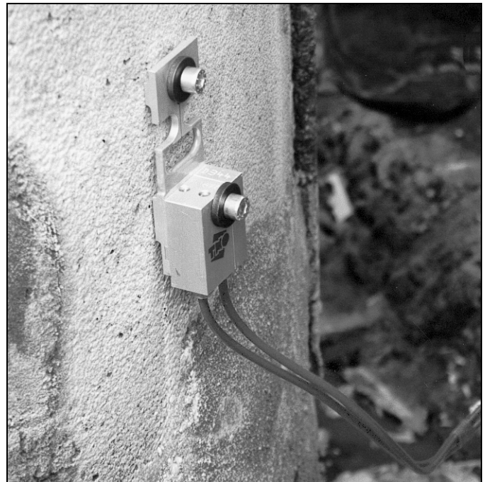
Rys. 1 Czujnik zamontowany na głowicy pala
