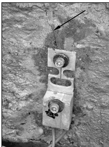
Rys. 8. Pęknięcie głowicy pala w czasie badania dynamicznego
