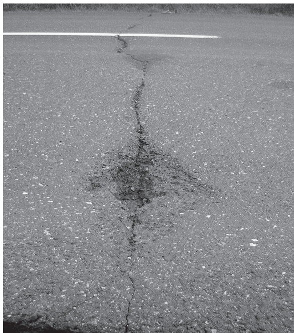
Rys.2. Przykład postępującego zniszczenia konstrukcji nawierzchni po powstaniu spękania niskotemperaturowego Fig.2. An example of proceeding deterioration of asphalt pavement after low temperature cracking has occurred
