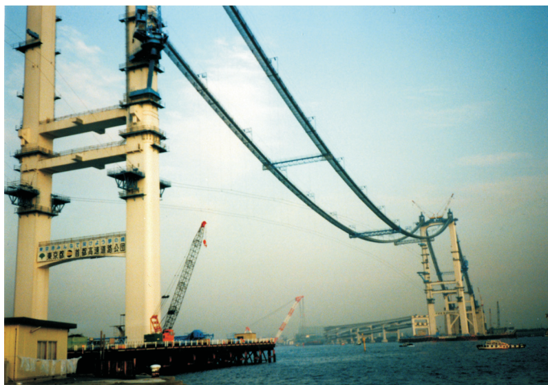
Rys.3. Pomosty robocze mostu wiszącego Fig.3. Mounting gangways of a suspension bridge (photo E.M. Kido: Rainbow Bridge 1991)
