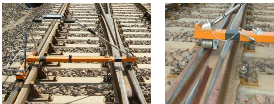
Fot. 4. Przejazd przez krzyżownicę – nieciągłość toku szynowego
