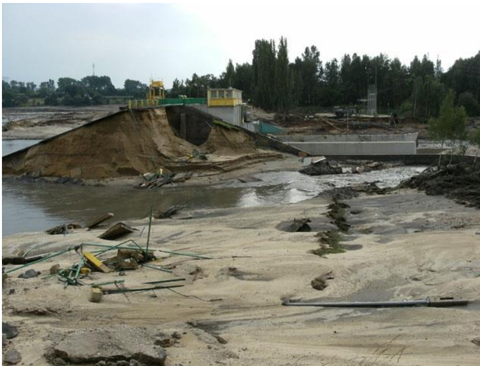
Rys. 1. Zniszczona zaporę ziemną Niedów na rz. Witka podczas powodzi w sierpniu 2010 r. ( http://www.zinfo.pl/galeria/187 )
