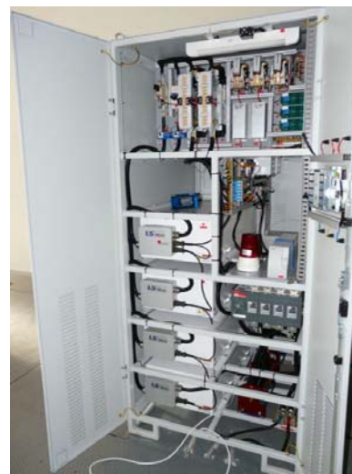
Rys. 3. Zasobnik superkondensatorowy zainstalowany w trolejbusowej podstacji trakcyjnej Północna w Gdyni; a – schemat rozmieszczenia aparatury, b – widok aparatury (1 – moduły superkondensatorowe, 2 – przekształtnik DC/DC wraz z układem sterowania, 3 – moduł zabezpieczeń i filtru wejściowego, 4 – moduły superkondensatorowe przewidziane do instalacji w przyszłości).
