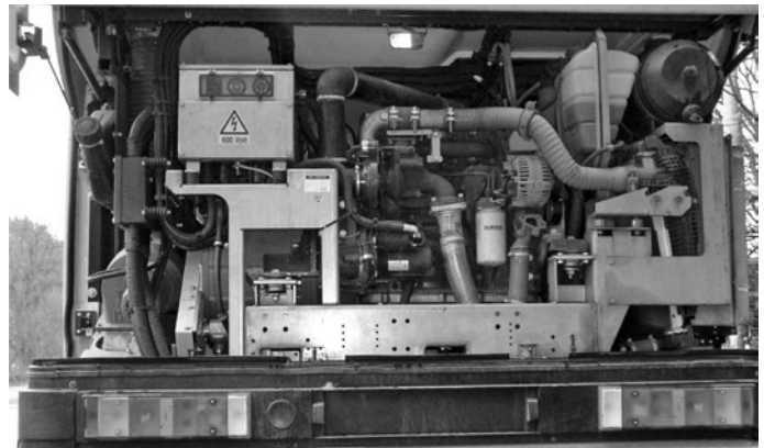
Fot. 2. Agregat spalinowy diesla zamontowany w trolejbusie Škoda 24Tr w przedsiębiorstwie trolejbusowym Zlín-Otrokovice, fot. Mikołaj Bartłomiejczyk
