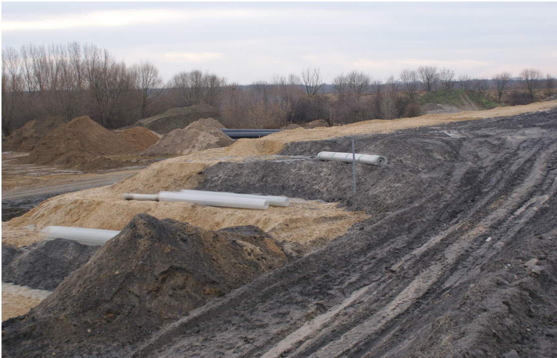
Zdjęcie 4. Fragment wykonanego nasypu. Widoczne fragmenty wykonane z samego piasku (skarpy) oraz mieszanka z UPS.
