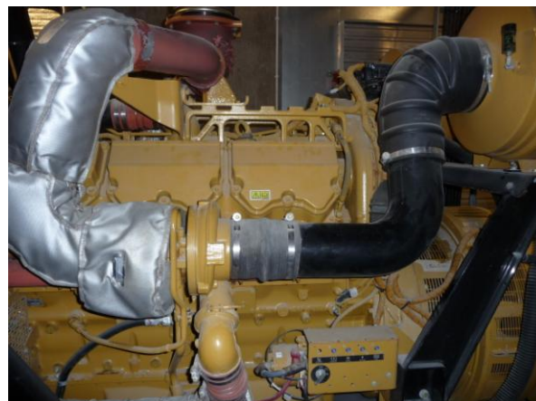
Rys. 4. Widok środkowej części zespołu spalinowo-elektrycznego o mocy 1000 kVA zainstalowanego w PGE Arena Gdańsk
