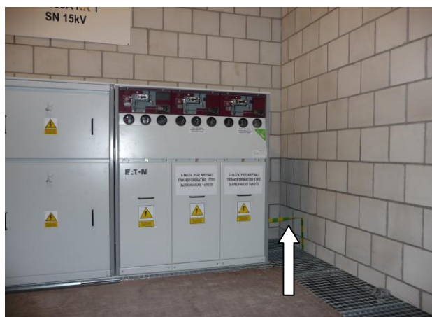
Rys. 6. Przewód uziemienia ochronnego w pomieszczeniu rozdzielnic 15 kV
