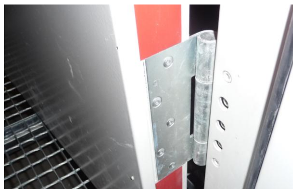
Rys. 7. Drzwi w pomieszczeniach technicznych (a) i ich zawiasy (b) zapewniające ciągłość galwaniczną skrzydła z ościeżnicą
