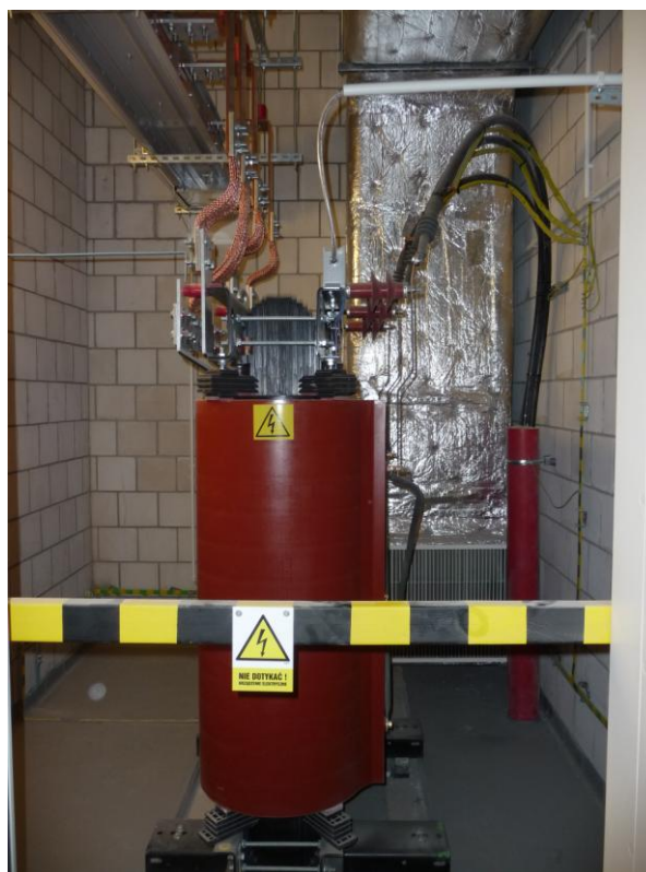
Rys. 3. Widok jednego z transformatorów 1600 kVA zainstalowanych w PGE Arena Gdańsk
