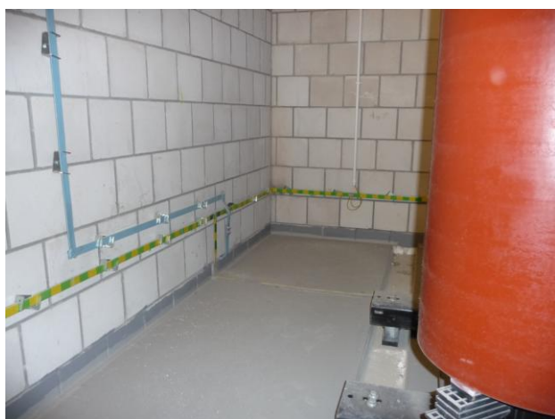
Rys. 5. Przewody uziemiające w stacji transformatorowej
