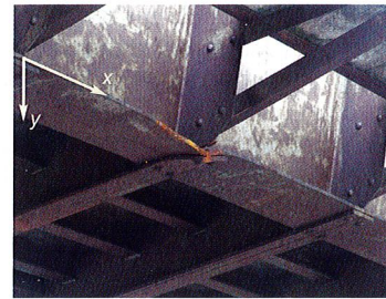
Deformacje pionowe krawędzi pasa dolnego
