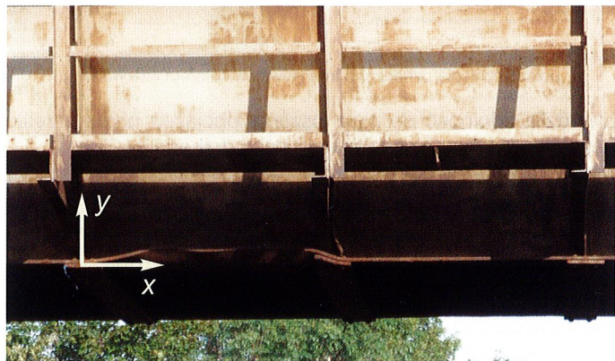
Deformacje pionowe krawędzi pasa dolnego
