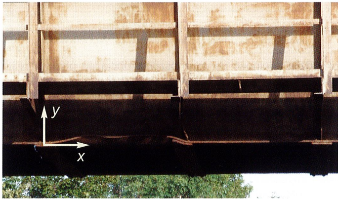
Deformacje pionowe krawędzi pasa dolnego
