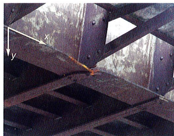
Deformacje pionowe krawędzi pasa dolnego
