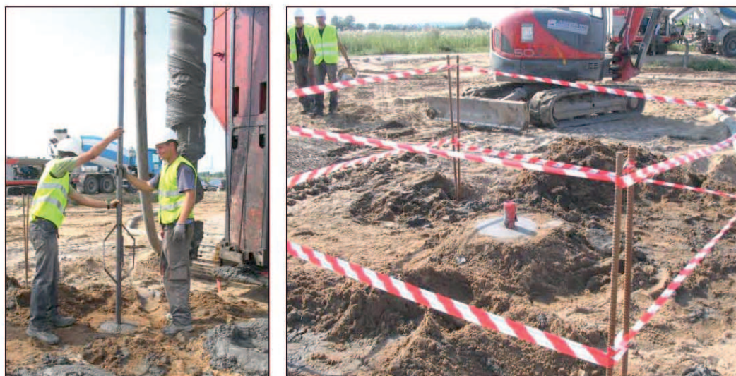
Fig. 5. Insertion of measuring equipment pipe and fully prepared pile. Rys. 5. Wprowadzanie rurki pomiarowej do pała oraz w pełni wykonany pał badawczy
