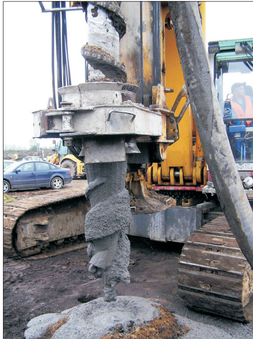
Rys. 5. Świder SDP \phi 356 mm: a) widok, b) w czasie pracy Fig. 5. The SDP auger of 356 mm diameter: a) view, b) during work
