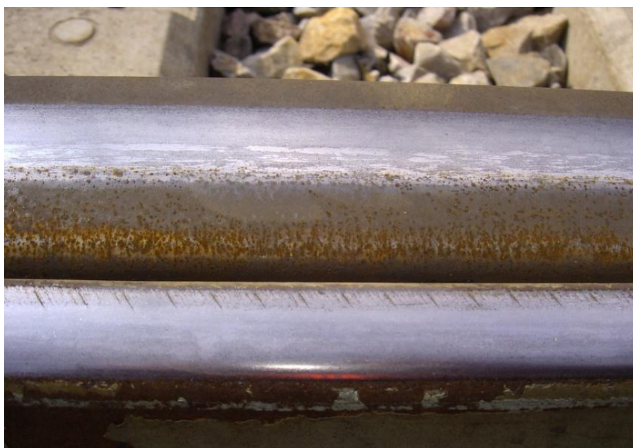
Fot.6. Uszkodzenie kontaktowo-zmęczeniowe iglicy
