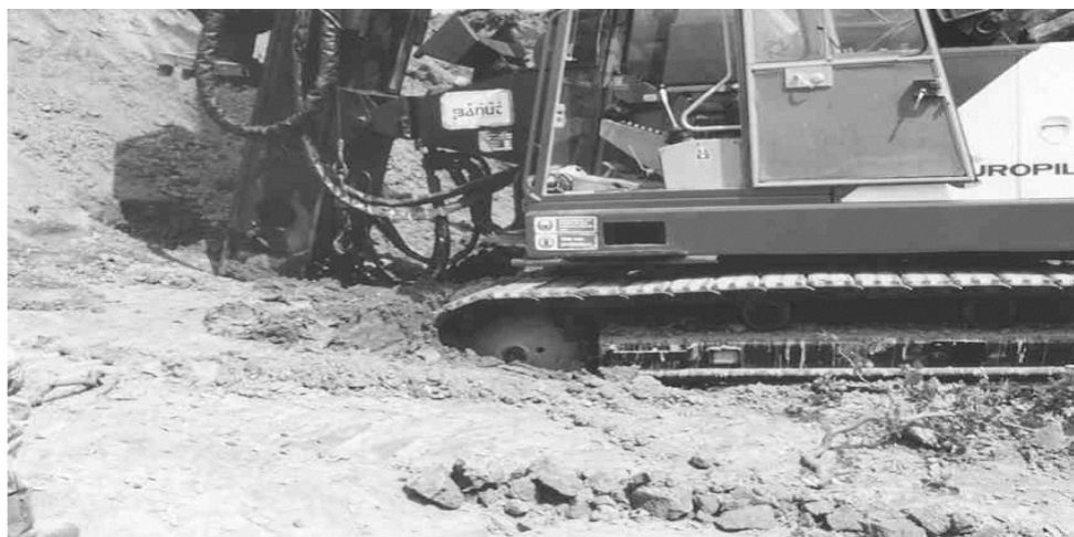
Rys. 1. Palownica „tonąca” z powodu nieodpowiedniego zagęszczenia materiału platformy roboczej [3]
