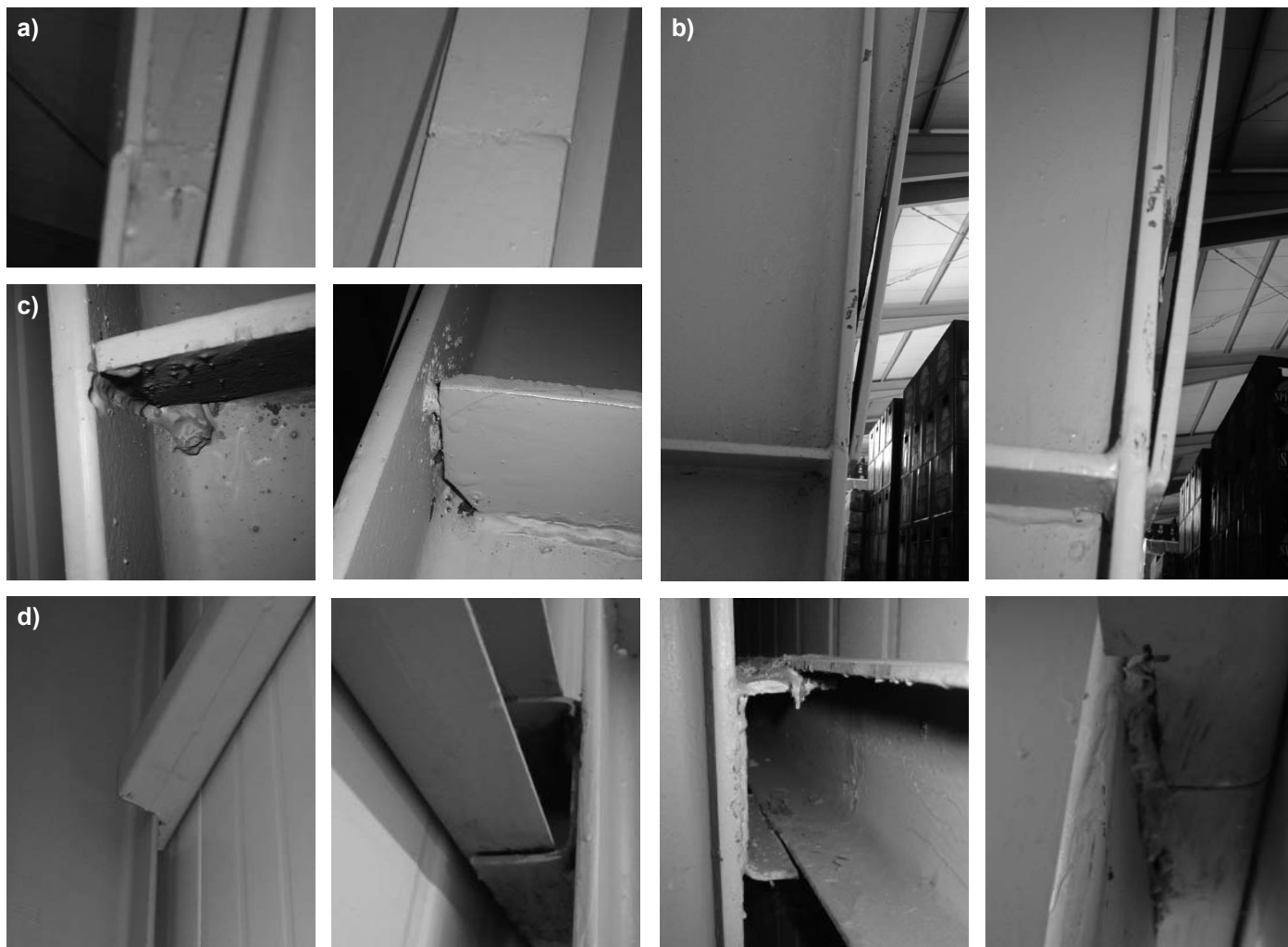
Rys. 2. Wybrane defekty wykonawcze obiektu o stalowej konstrukcji nośnej a) pęknięcie pasa dolnego w obrębie węzła, b) przykłady złego wykonania wzmocnienia, c) wady połączeń spawanych, d) przykłady łączenia elementów oryglowania ściennego do słupów konstrukcyjnych
